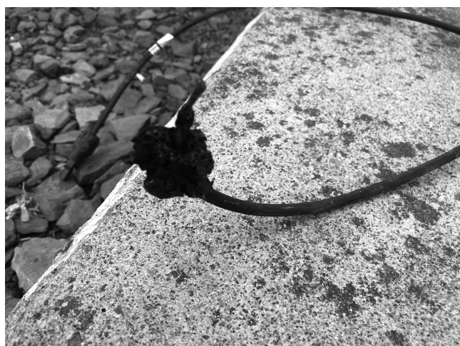
写真-7.4.2 バイパスダイオード高温化により発生したジャンクションボックスの焼損。ドローンアイ検査により発見された 出典) エナジー・ソリューションズ
